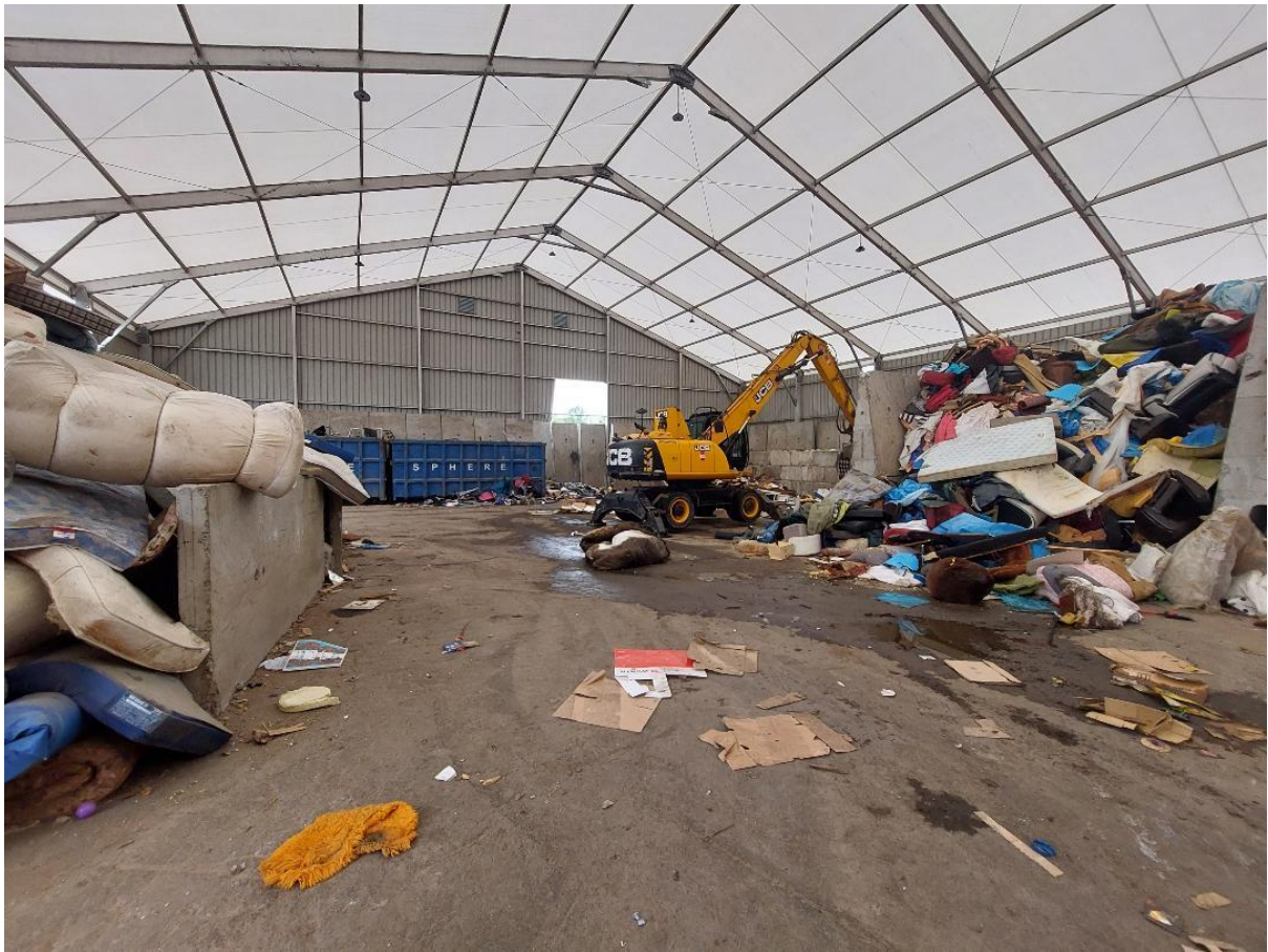
Tri à a pelle mécanique sous hangar de protection envols et pluie
